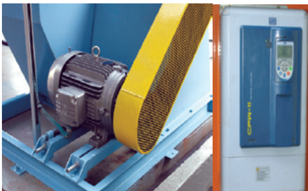
Motor WMAGNET + Inversor de Freqüência-CFW-11
