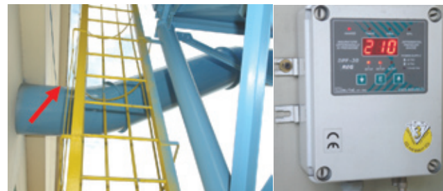
Ponto de instalação na tubulação Controlador DPF-REG-20
