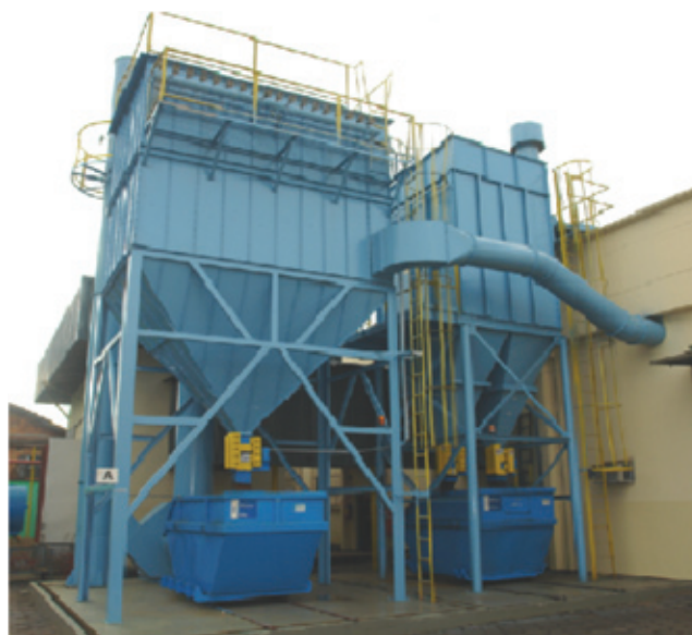
Sistema de Exaustão Vazão: 30.000 m 3 /h Pressão: 210 mmca Nº pontos de captação: 16 Diâmetro pontos de captação: 120 mm Velocidade nominal: 35 m/s Velocidade mínima: 25 m/s
